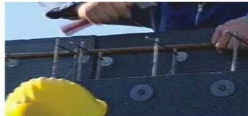
Fase di posizionamento con l'attrezzatura predisposta per sopportare il voltino e ricevere il getto.
